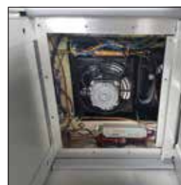
A5. Compartimento del condensador
