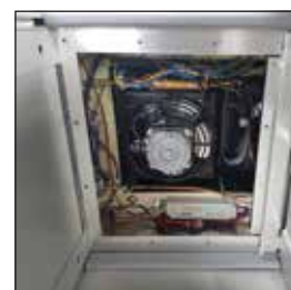
A5. Vano condensatore
